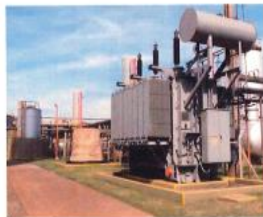
Transformador de Repuesto
