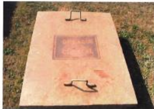
Cámara de toma de muestra y aforo
