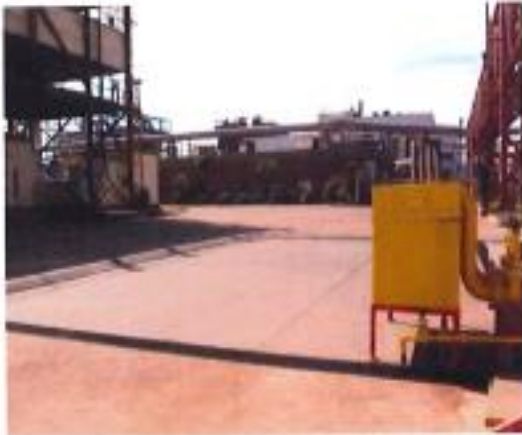
Playa descarga Combustible
