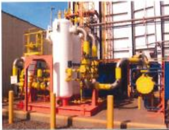
Acondicionamiento Gas Natural
