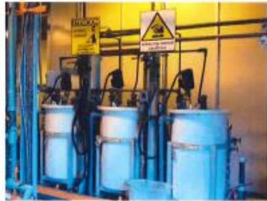
Dosificación de Químicos
