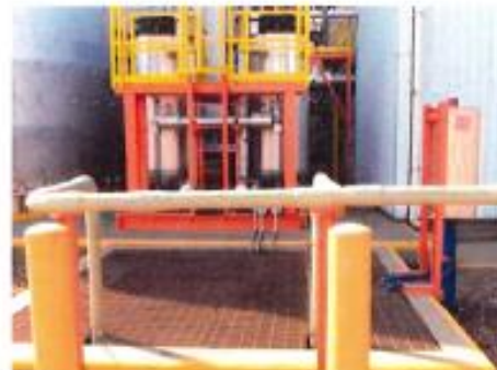
Tanque de drenaje efluente industrial
