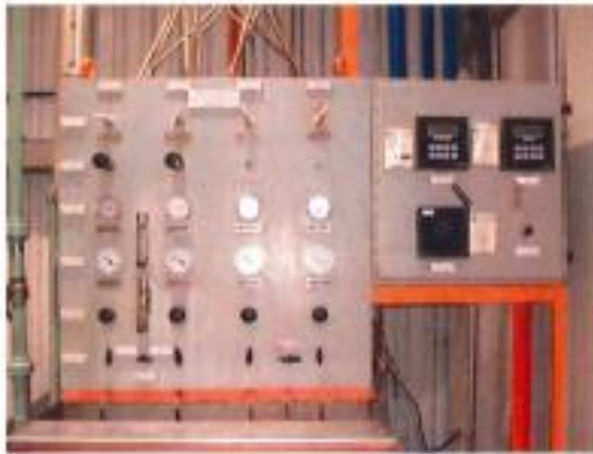
Panel Control Calidad Agua
